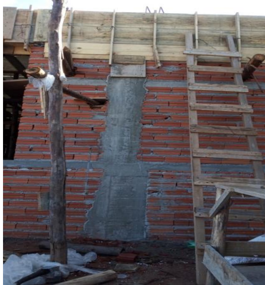
Figura 1 – Pilar irregular (obra 02)
