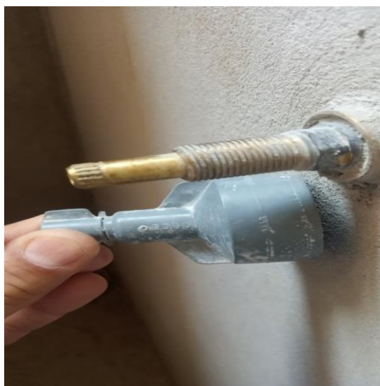
Figura 8 – Válvula sem proteção (obra 03)
