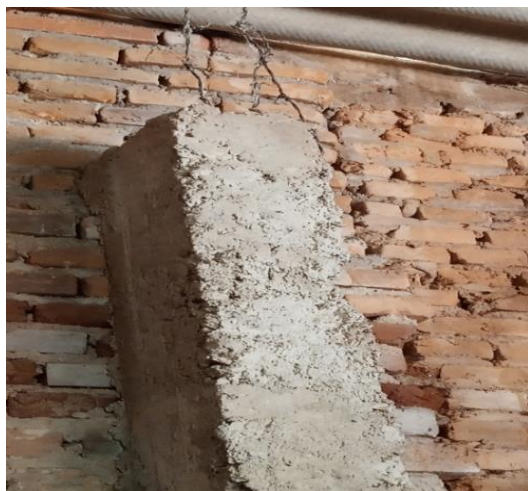
Figura 07 Pilar com arame farpado (obra 06)
