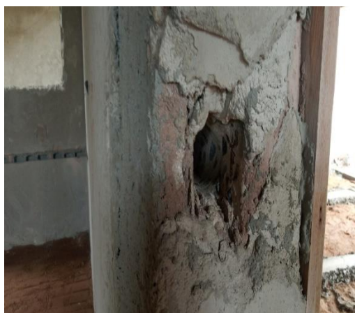
Figura 6 – Furo no pilar para passagem de fiação elétrica(obra 05)
