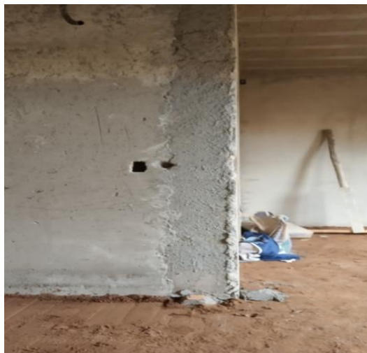
Figura 5 – Furo no pilar para passagem de fiação elétrica (obra05)
